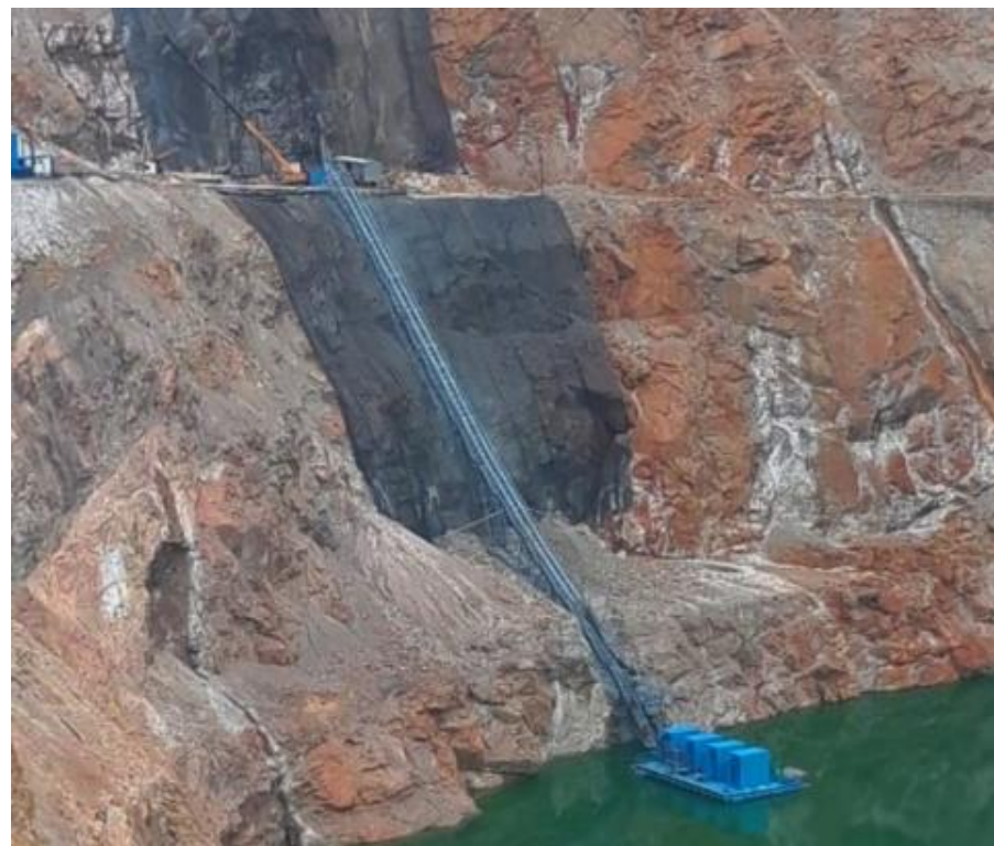
Складирование хвостов в отработанном карьере Николаевский, Восточный регион
